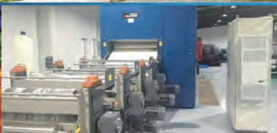
进口设备、接口国际(丝光防缩处理线)
